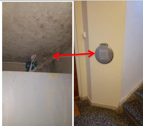
Bilde 11-12: Tidligere søppelsjakter i trapperommene er avstengt. Pga. mye lagring i søppelrommene, bør søppelsjakt stenges igjen i underkant, med brannmotstand A60.
