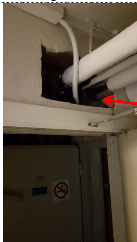
Bilde 7: Flere brannklassifiserte vegger har skader/hull, evt. med gjennomføringer som ikke er branntettet.
