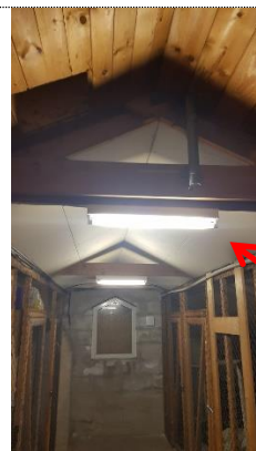
Bilde 15: Flere steder er deler av loftstak kledd på undersiden med gips. Det vurderes at dette ikke er del av påkrevd brannteknisk sikringstiltak.
