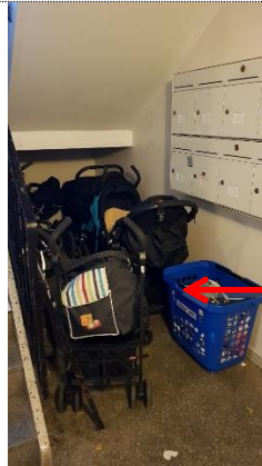
Bilde 4: Lagring av barnevogner, papir mm i bunnen av trapperom, som er rømningsvei.
