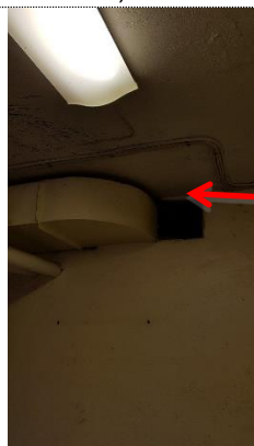
Bilde 14: Det ble registrert utette gjennomføringer av kabler, kanaler og rør generelt i vegger mellom underetasje/kjellerareal og trapperom, og mellom vaskerom og bodareal
