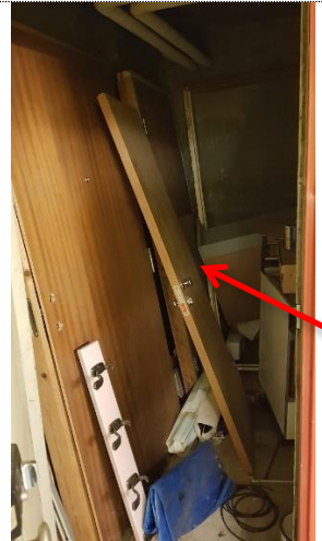
Bilde 10: Mange steder i bygget er det påfallende mye lagring av brennbart, som utgjør unødvendig stor brannenergi, og vil redusere rednings- og slokkearbeide.
